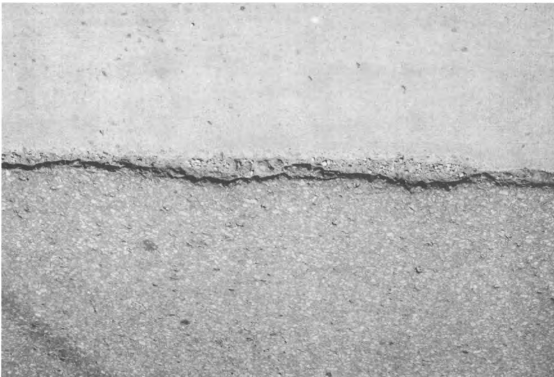
Pavement Edge Curb Separation
