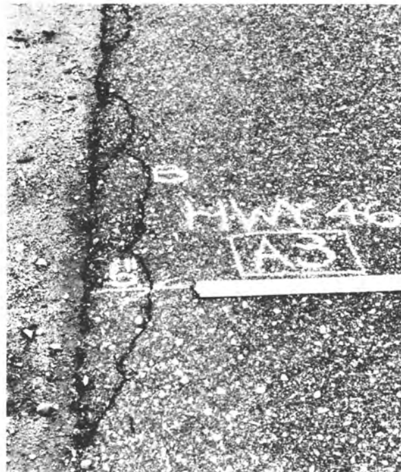
Slight Pavement Edge Crack (Wave Formation)
